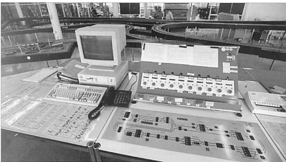
Vom Regiepult kann die ganze Anlage überwacht und gesteuert werden (Foto: D. Felix)
