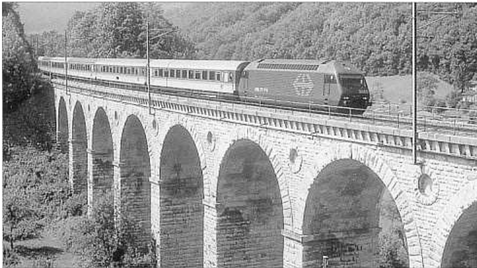
Als 1996 in Gelterkinden der Viadukt saniert wurde, leiteten die SBB einzelne Züge um (Rümligen, 15.7.96; Foto: M. Gerosa)
