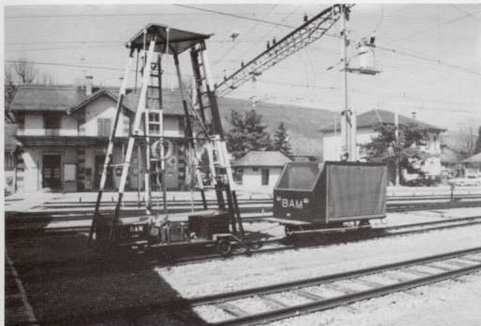
Die Komposition des Fahrleitungsdienstes mit DAM und Leiterrollwagen präsentiert sich vor dem Bahnhofsgebäude Bière (4.4.95, Foto M. Klausner)
