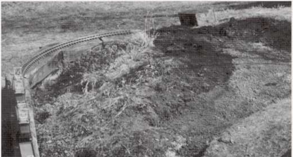
Während rechts die Dachpappe und der Schotter noch fehlen, sind links im Bild bereits die Geleise verlegt.
