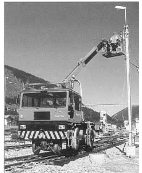
GSM 8003 bei Fahrleitungsmontage auf der Zufahrtsstrecke zum Zwischenangriff in Sedrun (Las Rueras, 25.8.98; Foto F+F; J. Blaser)
